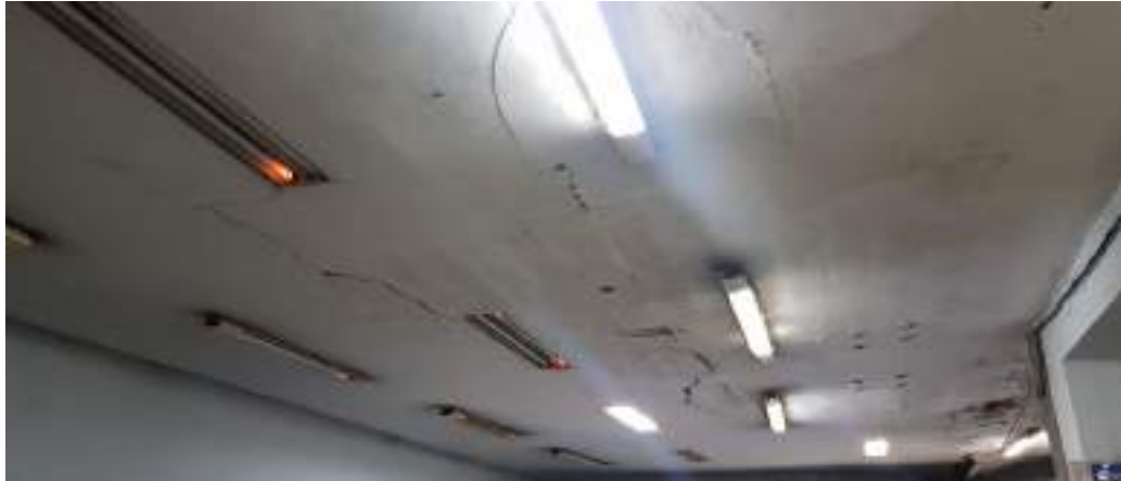
Foto 6: Techo y luminarias deterioradas del salón de venta.
